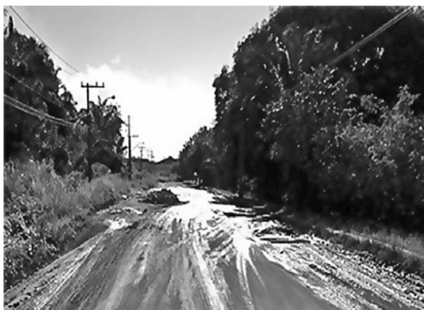
Figura 3 Estado de uma das pistas principais de acesso a empresas do PII
